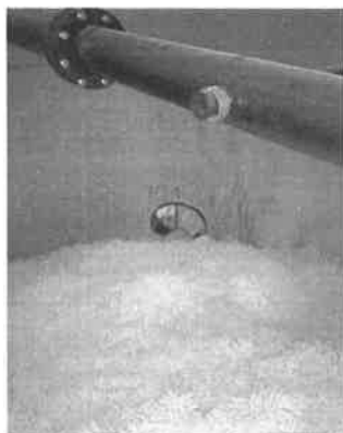
Garnissage en vrac d'une des tours de désodorisation
